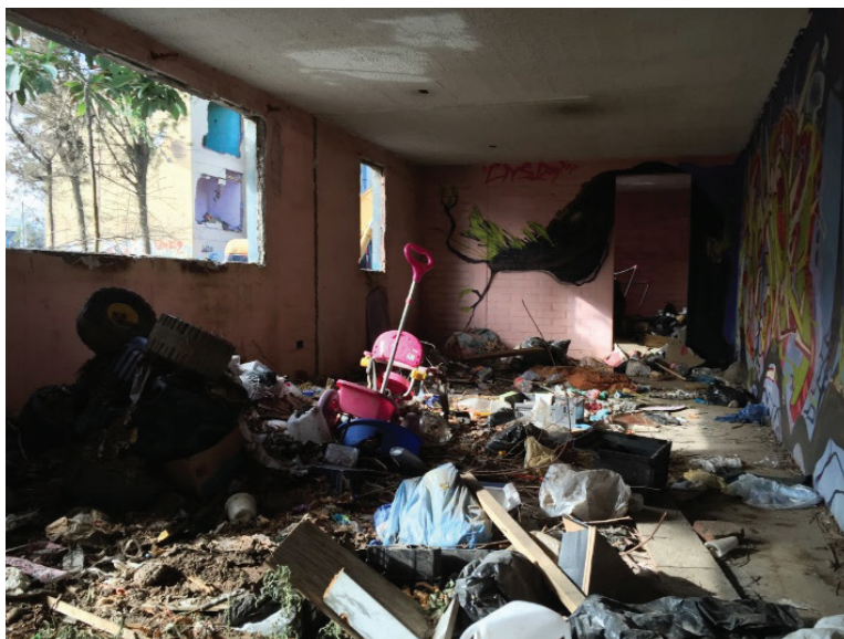
Imagen 4. Interior de un departamento semi destruido ocupado ilegalmente.
